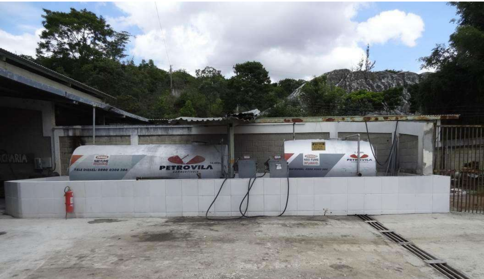
Tanques de combustível.
