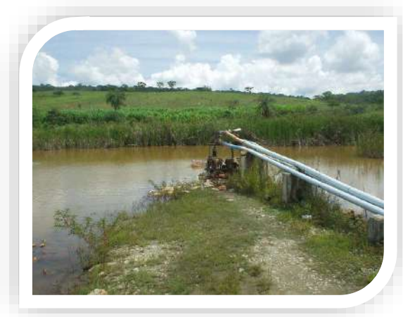
Estrutura para a captação de água superficial no Afluente do Ribeirão Betim.
