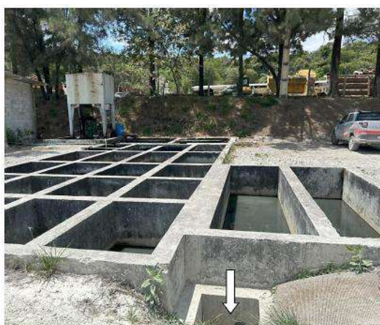
Caixas separadoras de água e óleo.
